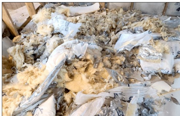
ネズミの巣になっていた1F天井裏の断熱材
