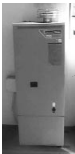
取替え前の給湯器
