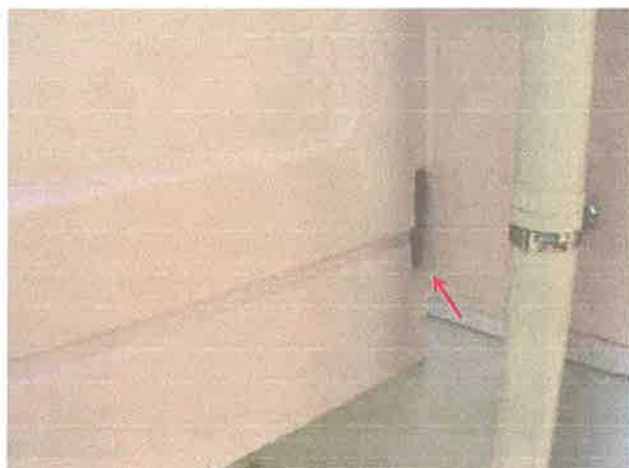
バルコニーは無断熱で塗装の色合わせが行われている。
