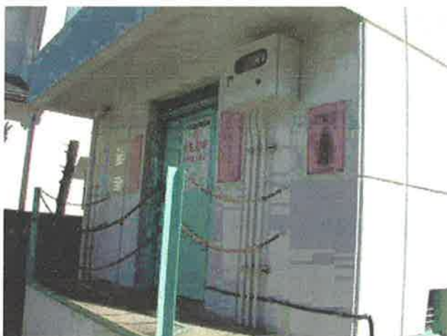
電気・ガス・給水ポンプ室北側
