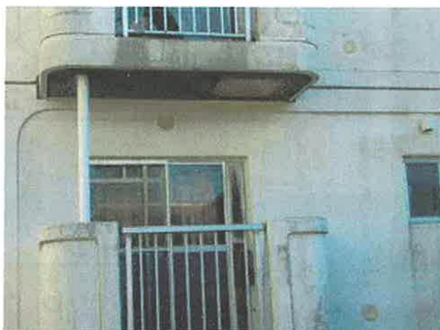
5号棟は未改修で汚れが目立つ。
