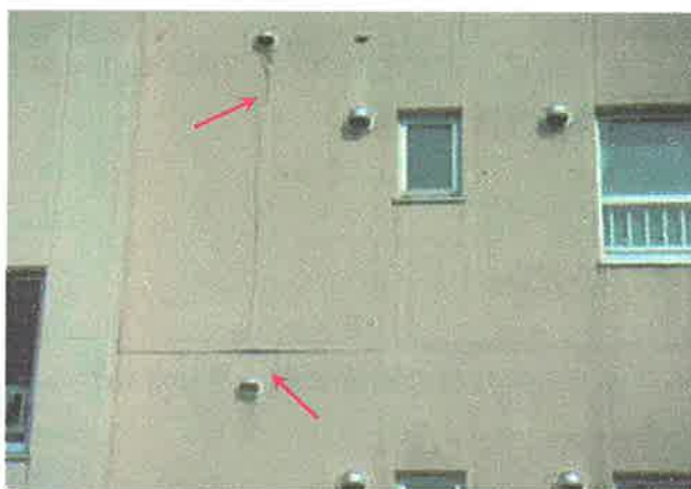
換気口の凍害と断熱材の剥がれ
