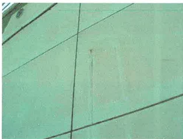
6号棟の妻側に外壁の「爆裂」が見られる
