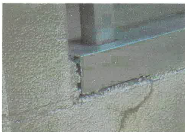
手摺り脚部の剥がれ
