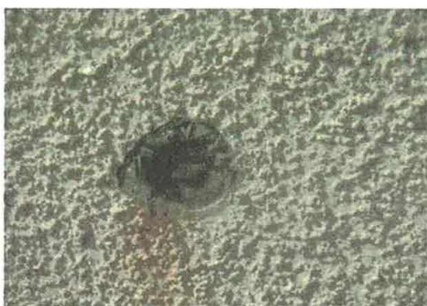
アンカーの錆
