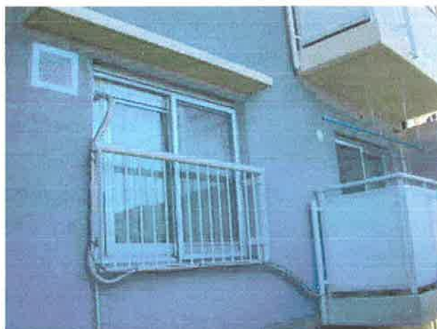
窓脇には換気システムの吸気口がみえる
