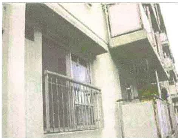
バルコニーや外壁の汚れが目立つ
